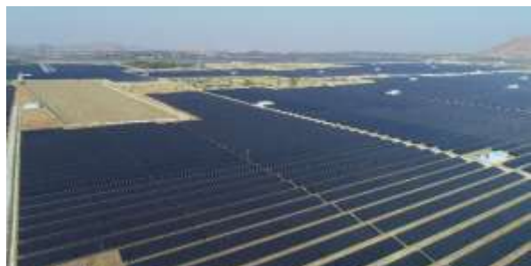
2050 MW Pavagada Solar Park
